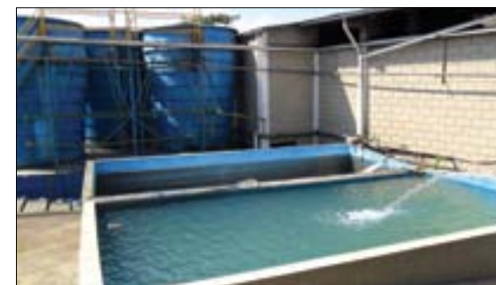
Estação de Tratamento de Efluentes
